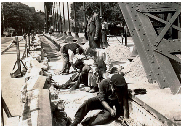
Rys. 3. Prace remontowe w obrębie pomostu w 1939 r.; widoczna tabliczka znamionowa firmy J.E. Christoph A.G. (źródło: zbiory prywatne Józefa Rabięgi)
