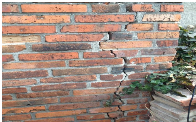
Rys.10. Widok uszkodzonej konstrukcji murowej
